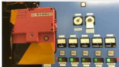
動力盤電圧電流計
