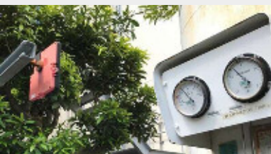
外部タンクメーター
